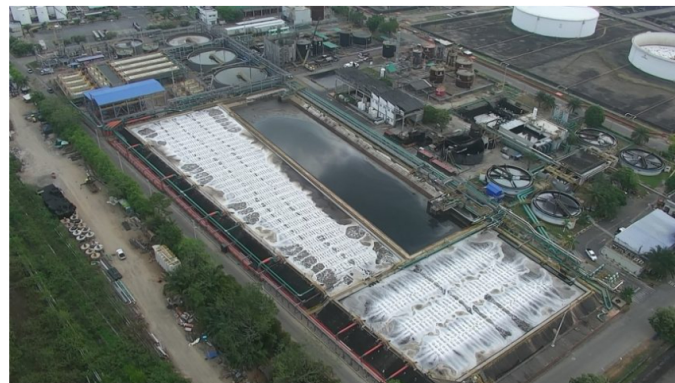
Foto: En cuenta X de @ECOPETROL_SA / Ecopetrol / Planta de tratamiento de aguas residuales – PTAR – en la Refinería de Barrancabermeja de Ecopetrol.
